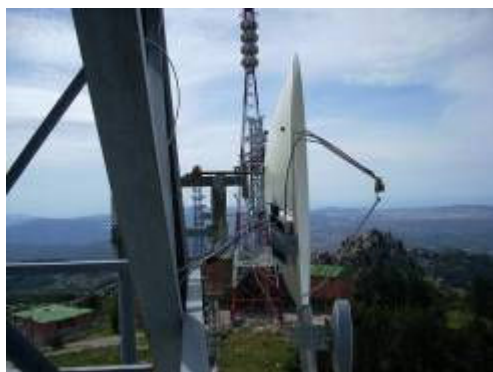
ANTENNA ED APPARATO SU M.LIMBARA
